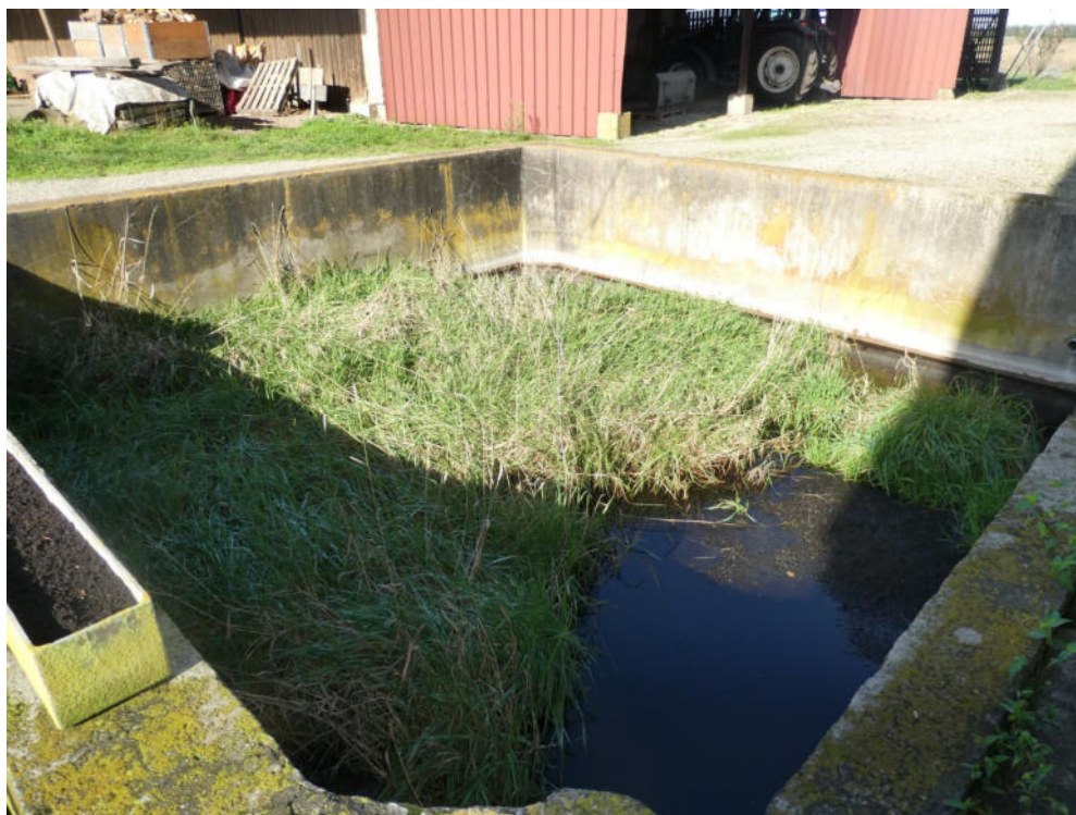
Foto 4: Wasserbecken auf Flst. 4824
